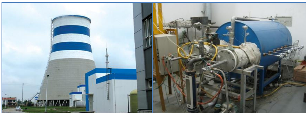
电厂热能动力设备天然气蓄热式燃烧
